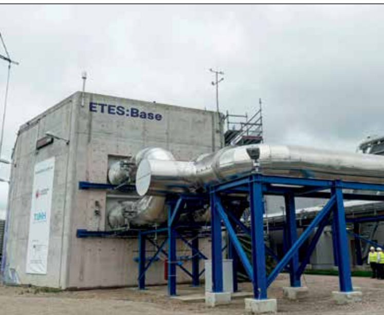
Пилотная установка ETES в Гамбурге-Альтенвердере может хранить до 130 МВтч тепловой энергии в течение недели.
