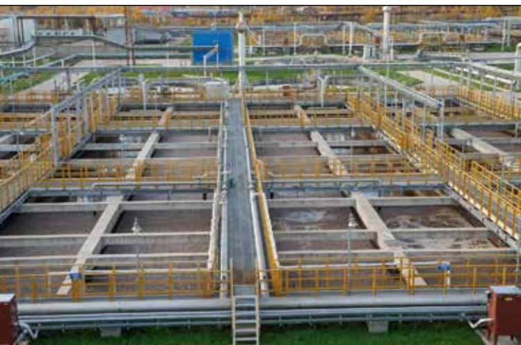
Биологические очистные сооружения «Уфанефтехима».
