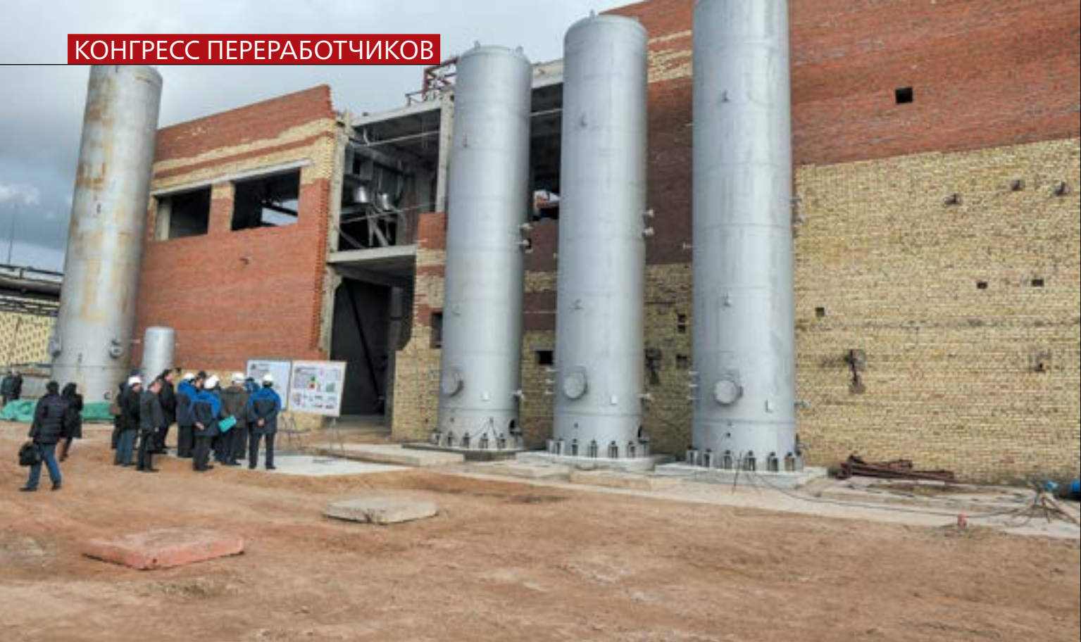
Выезд республиканского штаба строительства завода «КЗСК-Силикон» с участием президента Татарстана. В 2017 году после серии драматических событий объявлено о банкротстве строящегося завода.
