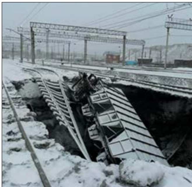
Провалы в районе железнодорожной станции Березники.
