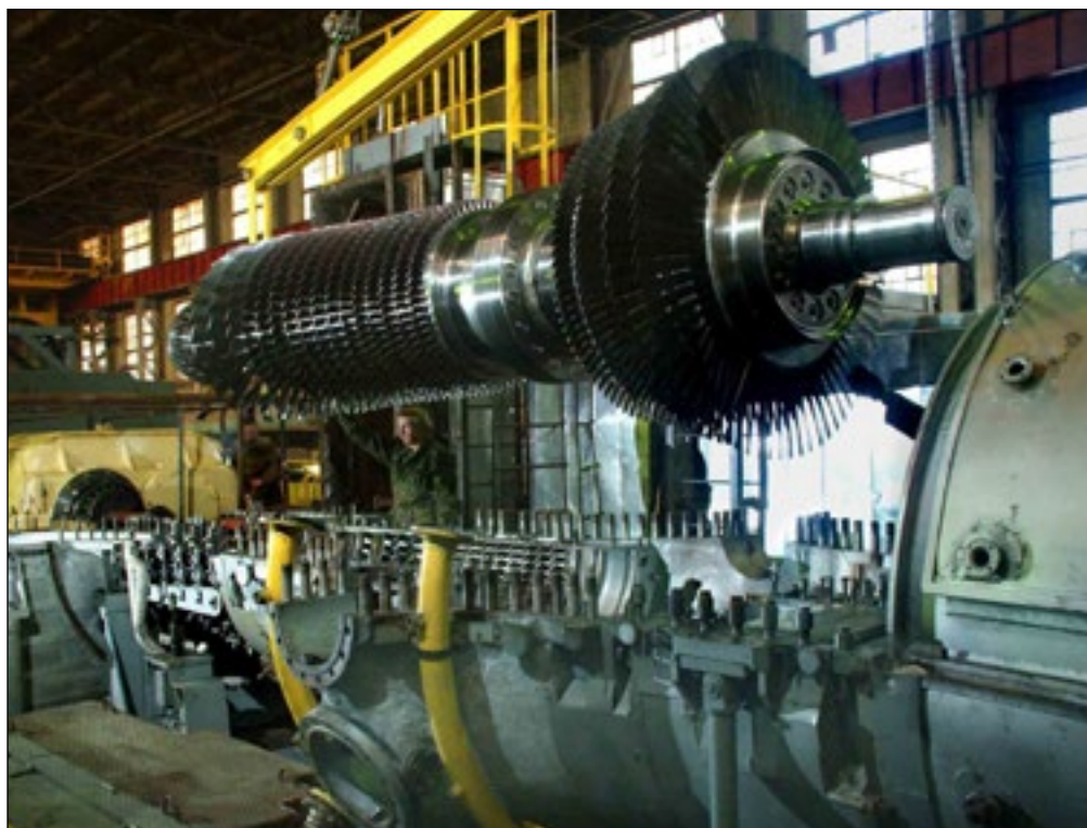
В 2016 году производство на АЗП было остановлено вследствие поломки компрессорной турбины.
