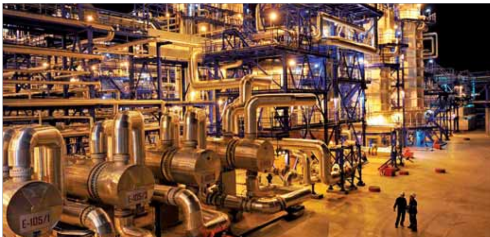
Установка гидроочистки бензинов каталитического крекинга на Омском НПЗ
