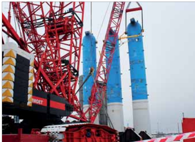
Строительная площадка комплекса глубокой переработки тяжелых остатков нефти ОАО «Таиф-НК», октябрь 2014 года
