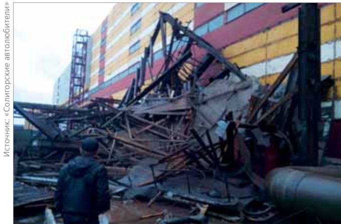
Обрушение металлоконструкции, ОАО «Беларуськалий»
