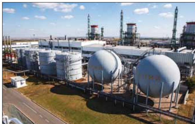
Оренбургский газоперерабатывающий завод
