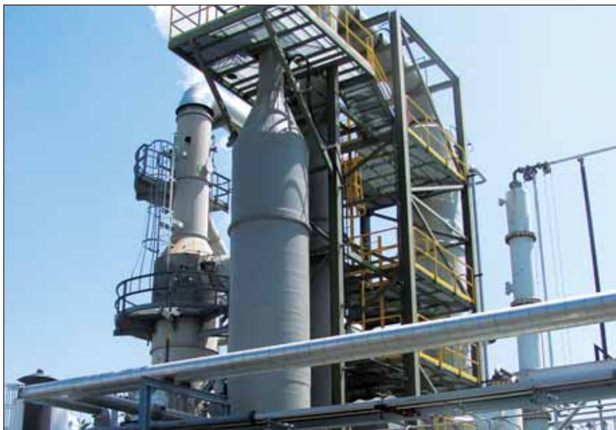
Установка для каталитической очистки газов от сероводорода, США
