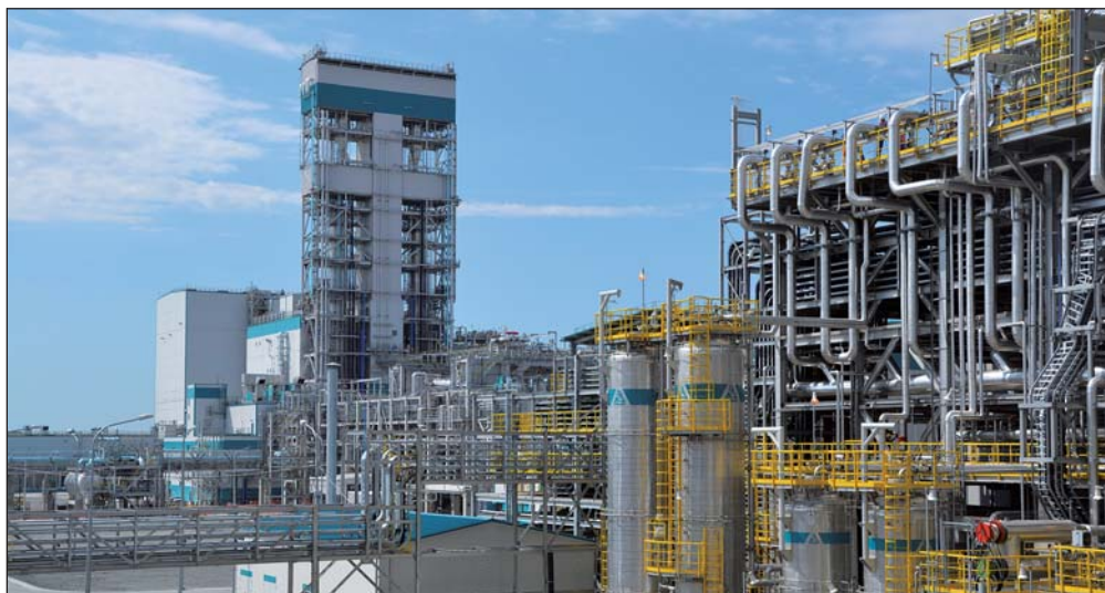
Комплекс «Тобольск-Полимер» состоит из установки по выпуску полипропилена мощностью 510 тыс. т и установки по производству полипропилена мощностью 500 тыс. т в год
