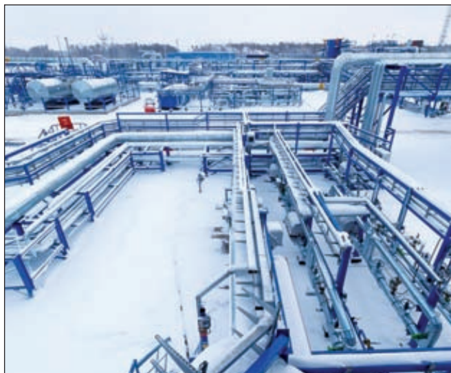
Южно-Приобская компрессорная станция
