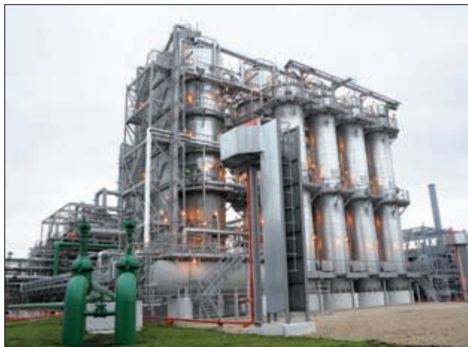
«САНОРС» 22 октября ввела в эксплуатацию установку по производству метил-трет-амилового эфира (МТАЭ) мощностью 300 тыс. т в год
