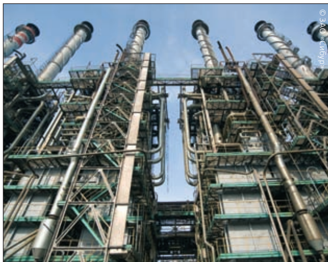
Производство ОАО «Сибур-Нефтехим НХЗ». Печи пиролиза, г. Кстово
