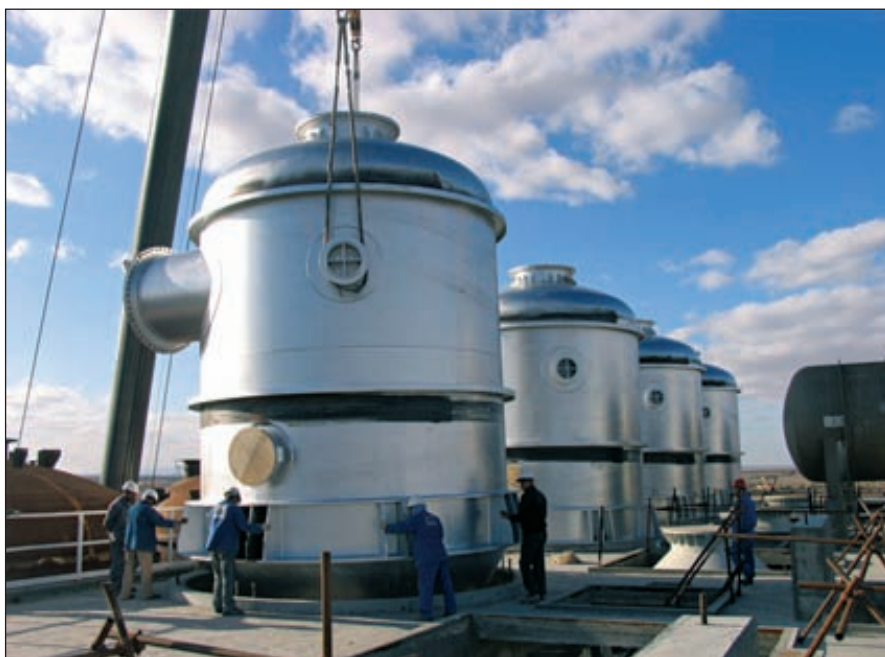
Строительство завода по производству фосфорной кислоты в районе Skhira (Тунис) мощностью 360 тыс. т/год
