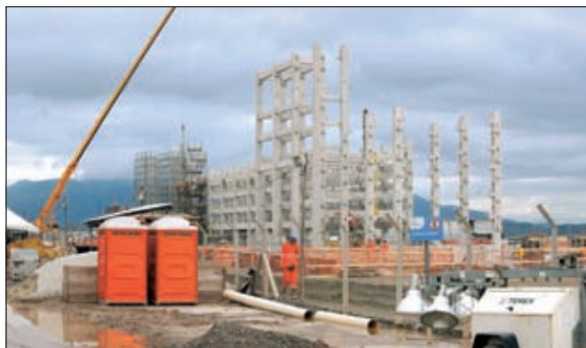
Petrobras ведет строительство двух НПЗ на площадке нефтехимического комплекса Comregj (штат Рио-де-Жанейро, Бразилия)
