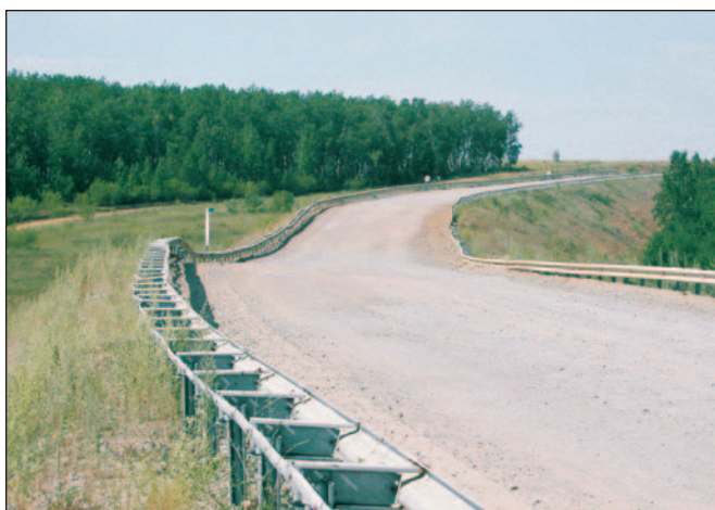
Рис. 1. Деформации автодороги «Амур» Чита–Хабаровск, 247 км, вследствие оттаивания вечной мерзлоты в основании
