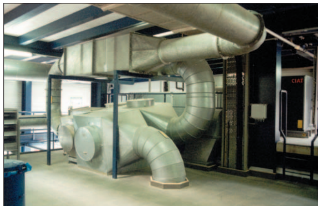
Около 15 процентов энергии теплоноситель получает из отработанного воздуха сушильной установки
