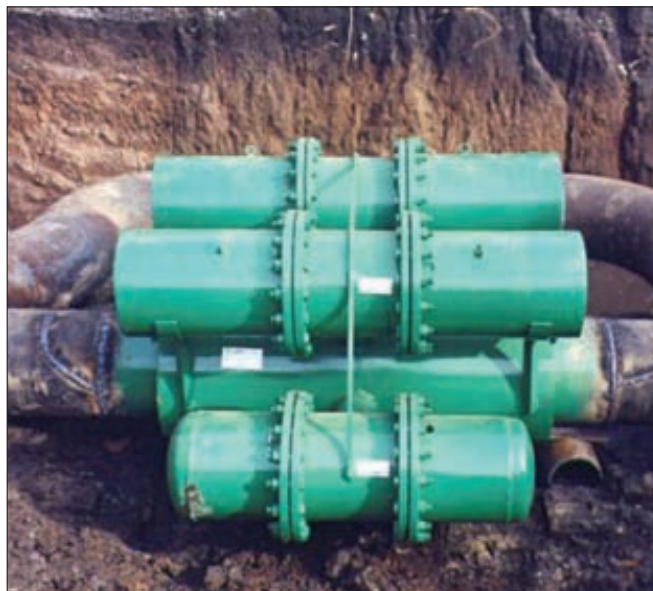
Рис. 1 Стабилизатор давления на трубопроводе
