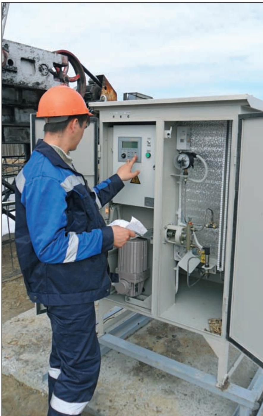
Установка дозирования химреагента, Нягань (Ханты-Мансийский АО)
