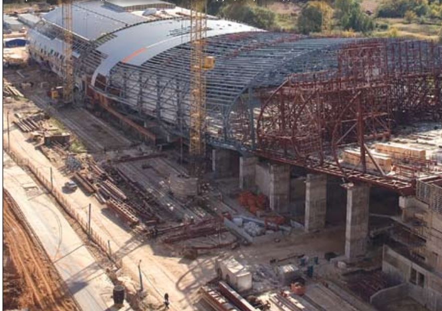
Горнолыжный комплекс «СнежКом» в Красногорске строился с применением материала Emaco S33 для монтажа металлоконструкций производства BASF
