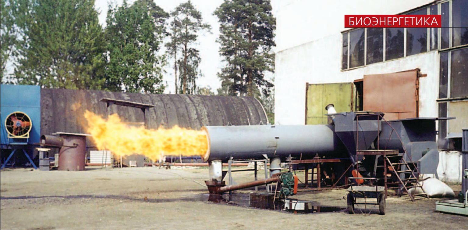
Пятимегаваттная пилотная установка для получения энергии из твердой биомассы
