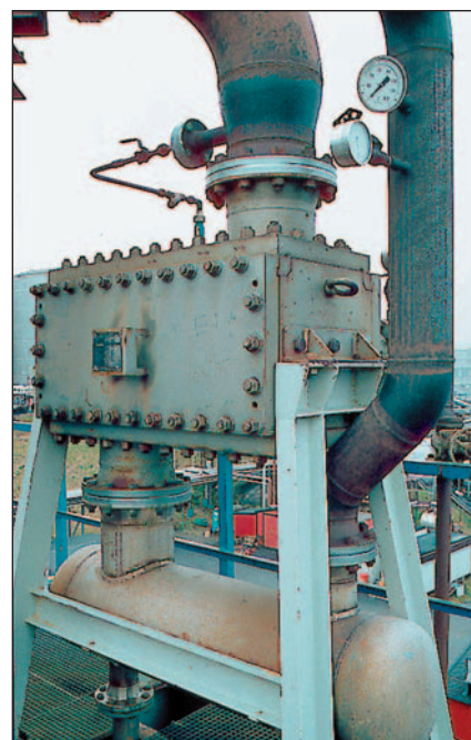
Рис. 2. «Компаблок» в качестве конденсатора паров, установленный на НПЗ в Швеции, г. Нунас
