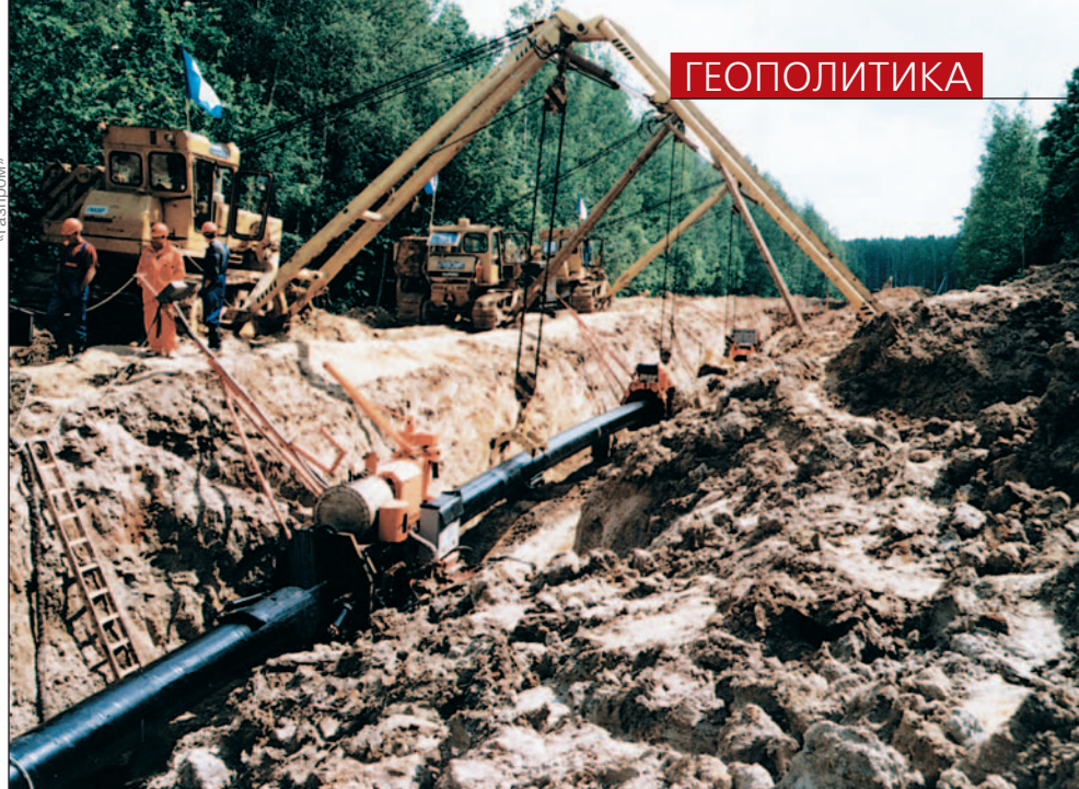
Строительство газопровода «Ямал-Европа». Газопровод выйдет на проектную мощность 30 млрд куб. м в год в III квартале 2005 года
