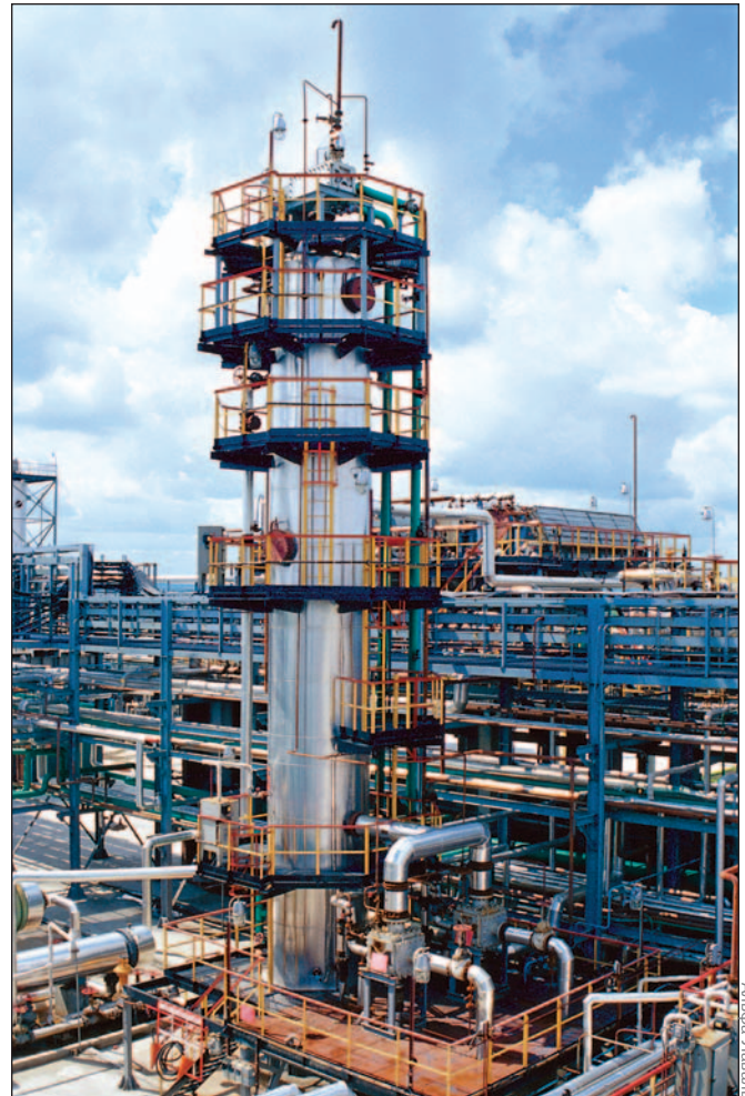
Рис. 2. Сызранский НПЗ. Верх колонны — конденсатор Comrabloc, низ колонны — ребойлер Comrabloc
