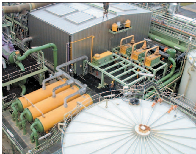
Рис. 3. Замена кожухотрубных конденсаторов аммиака на Comrabloc. Площадь размещения сокращена в два раза
