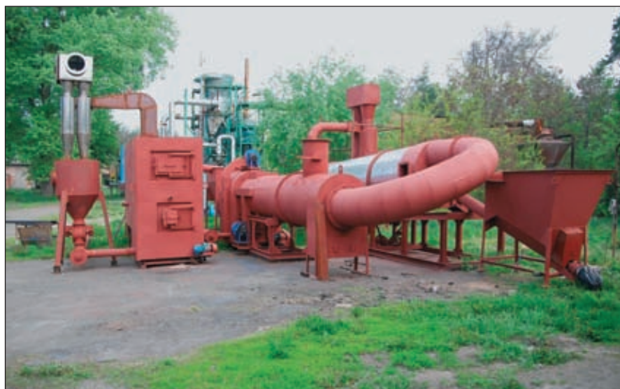
Установка мини-ТЭС электрической мощностью 315 кВт/час
