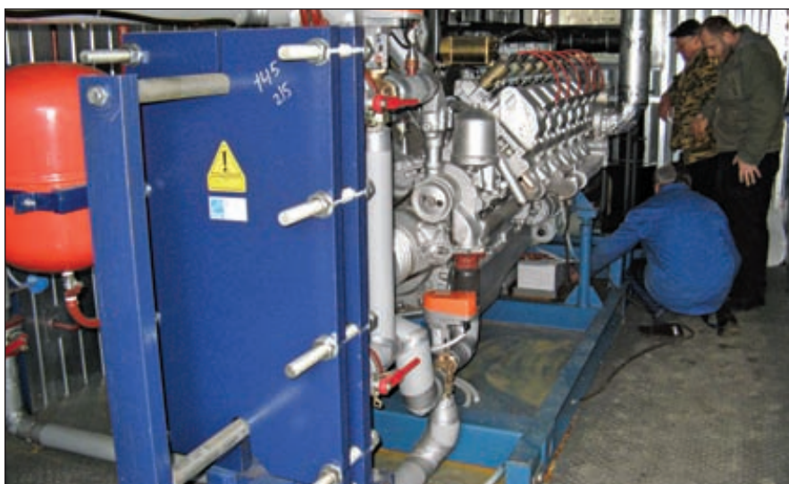
Электрогенератор установки мини-ТЭС ЗАО «Биоэнергетик» электрической мощностью 315 кВт/час. Установки для переработки ТБО и других отходов методом высокотемпературного пиролиза в течение 9 лет поставляются на рынки СНГ
